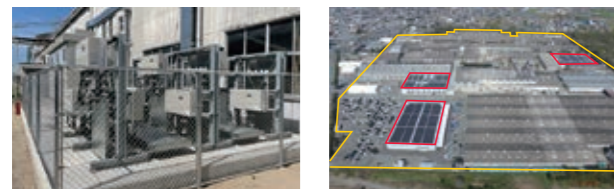
太陽光発電キュービクル
